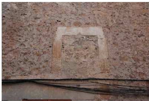
Finestra condemnada al carrer de la Soledat.
